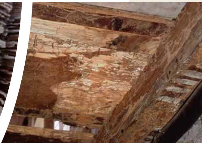
Attaques sur un solivage de plancher
